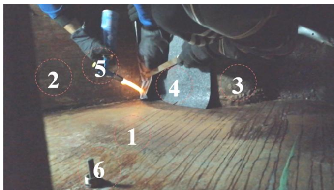
Рисунок 4. Герметизация стыков соединения боковой, торцевой стены и с донной частью биореактора облицованием термо и гидростойким материалом «Изостекло» факельным наплавлением
